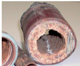
Twarda woda to zagrożenie dla kotłowni – powoduje m.in. znaczne obniżenie sprawności cieplnej urządzeń
